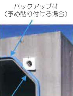
バックアップ材 (予め貼り付ける場合) 充填前 高弾性接着剤の充填部 (内目地)
