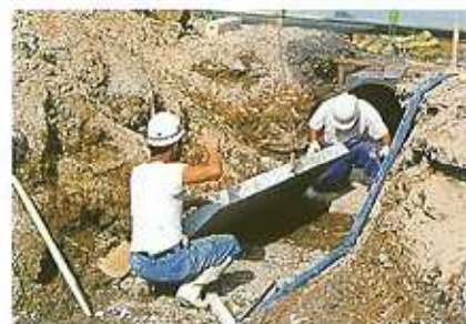
注) II型の基礎板を施工する際は、0.5t用のフックを使用してください。
