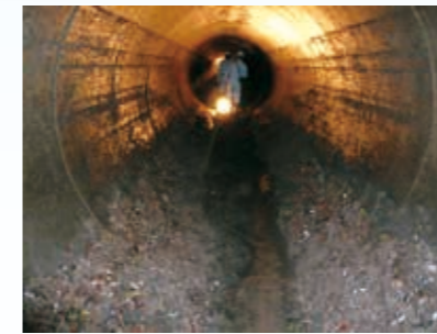
●雨水貯留浸透管
